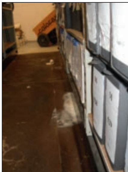
Faire face aux imprévus : développement de moisissures sur le faux-plancher (15/07/2009) © Marie-Agnès Dubos
