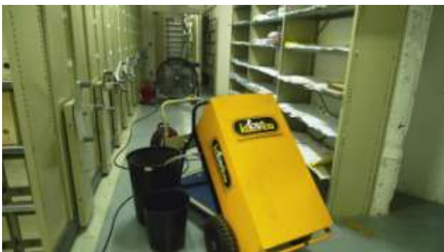
Le seau le plus petit a provoqué une inondation, il a été remplacé par le plus grand
